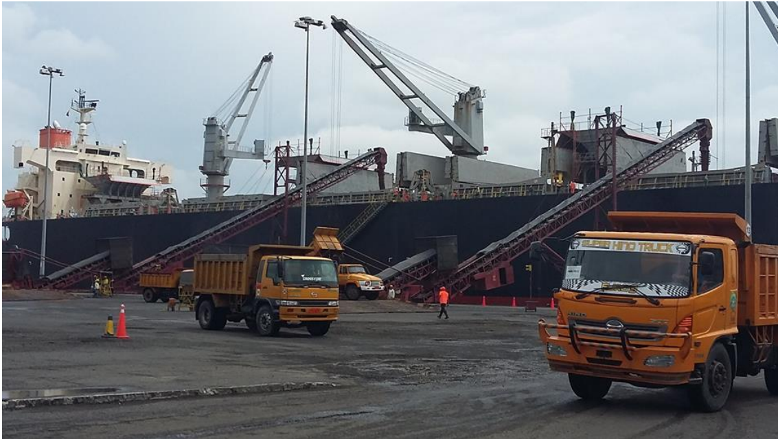
Durante el proceso de carga de astilla, dentro de las bodegas de la embarcación.
